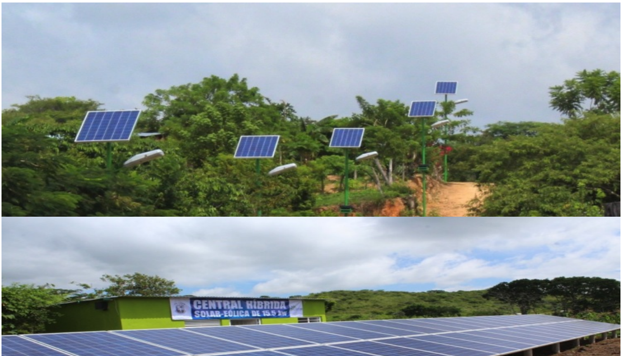
Figura 2. Implementación de Sistemas Energéticos en la Comunidad Villa del Río, municipio de Cintalapa, Chiapas.
